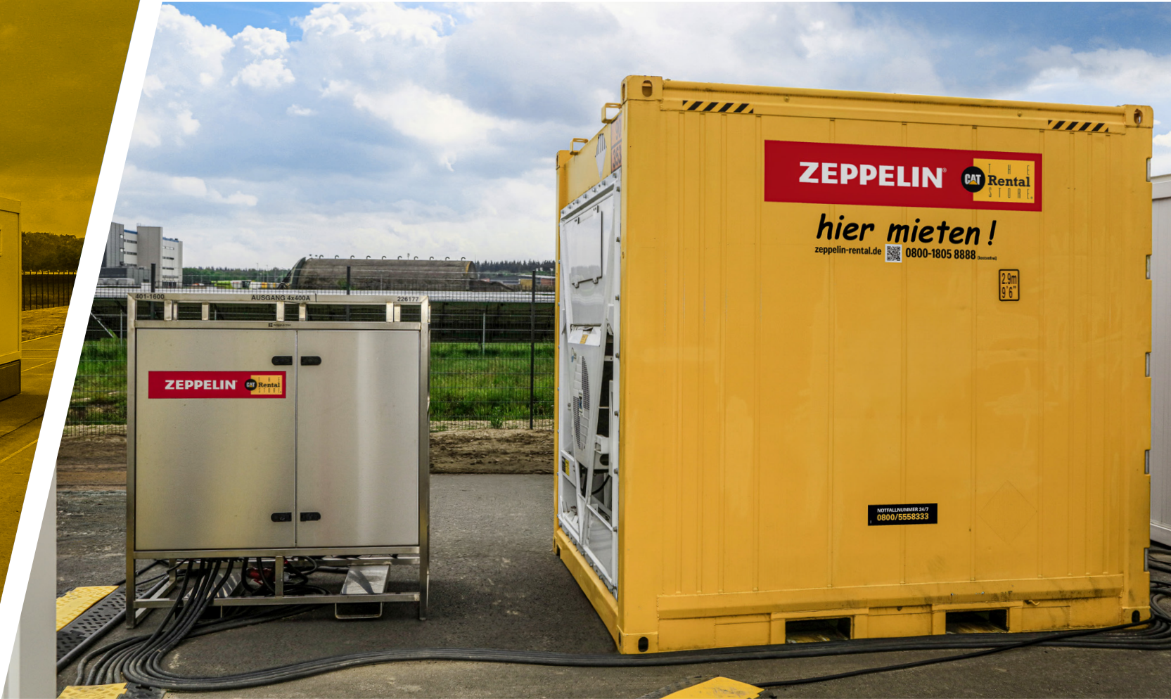
Über die Niederspannungshauptverteilung (links) wird der Strom an die einzelnen Verbraucher verteilt
