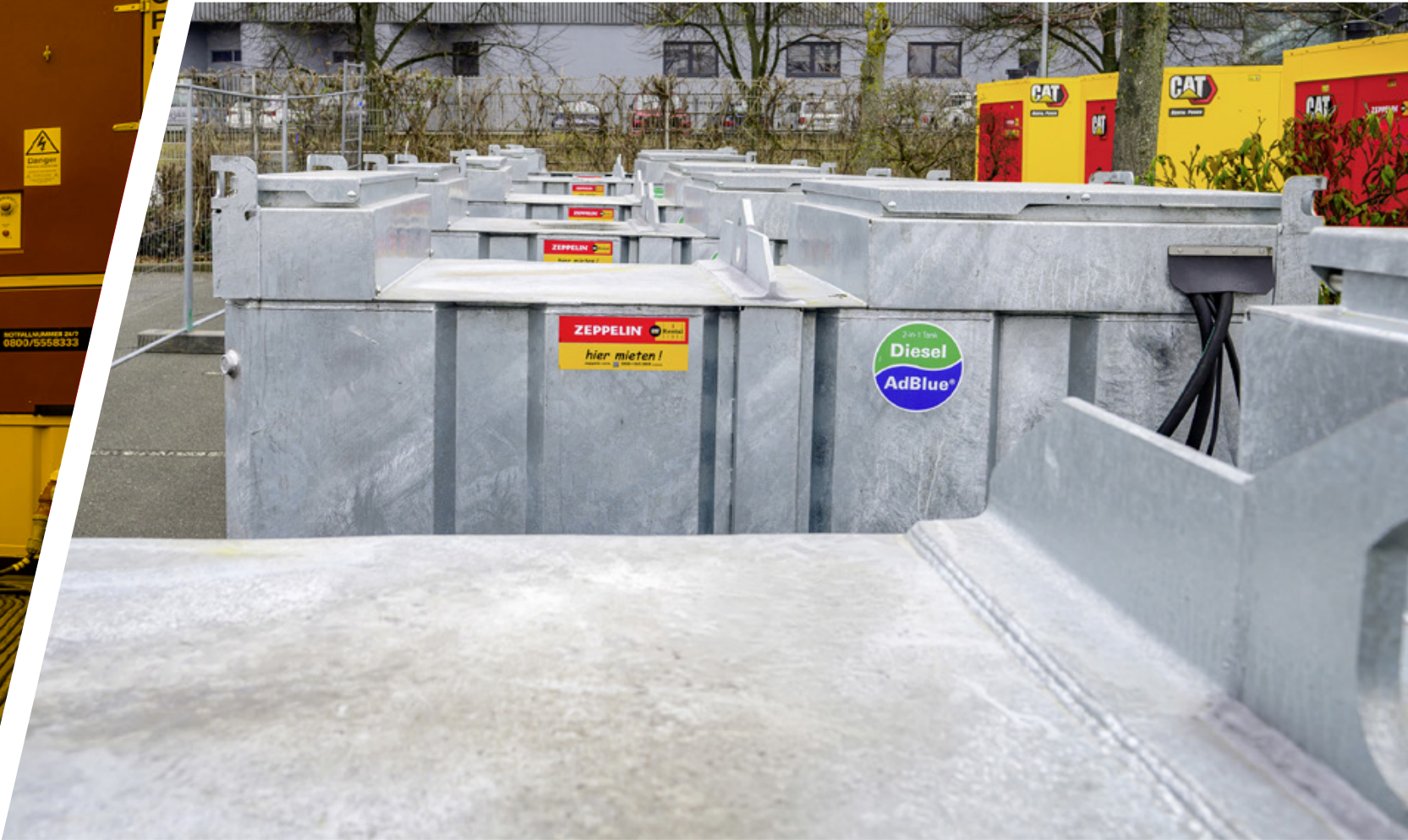
Sechs Duo-Tanks mit je 3.000 Litern Fassungsvermögen bevorraten sowohl Diesel als auch AdBlue
