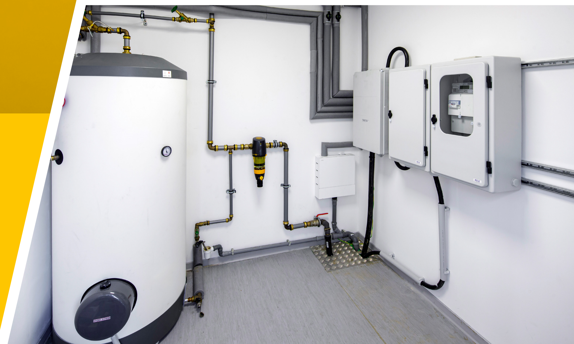
Der Technikraum bietet Platz für den Warmwasserboiler, die Klimasplitgeräte befinden sich auf dem Dach
