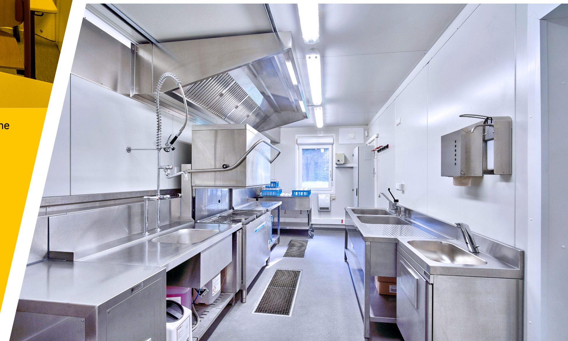
Auch die hochwertige Spülküche war zuvor bei der Anna-Lindh-Schule im Einsatz
